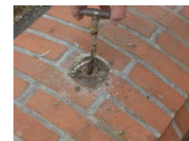
Korrosion an Fangeinrichtung
