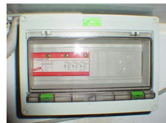
Nachträglich eingebauter Überspannungsableiter der Fa. DEHN in einen Isolierstoffkasten neben der Hauptverteilung
