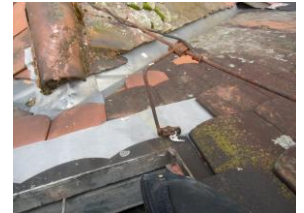
Korrosion an Fangeinrichtung
