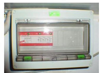
Nachträglich eingebauter Überspannungsableiter der Fa. DEHN in einen Isolierstoffkasten neben der Hauptverteilung
