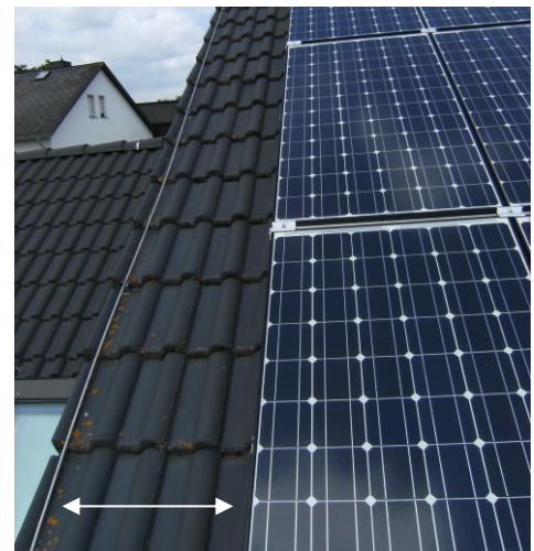
Beispiel für Trennungsabstand zwischen Fangleitung (links) und PV-Anlage
